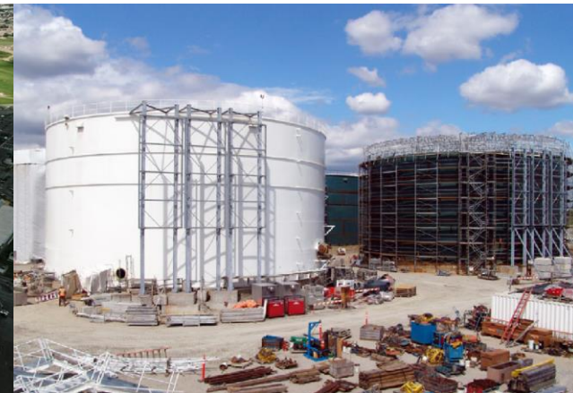
Parc de carburant aéroportuaire - Toronto
